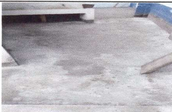
Foto 3: Finalización de reparación de red de drenaje y red de agua potable.
